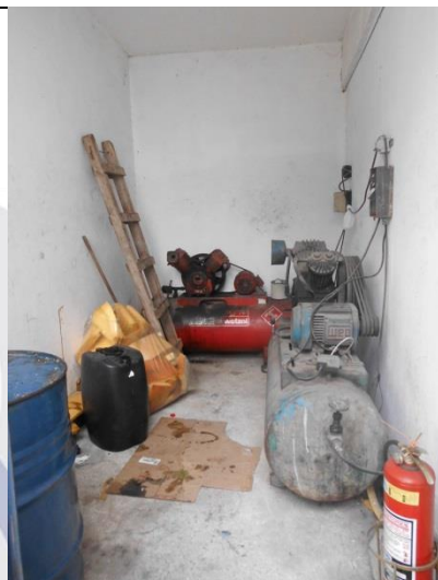
Vista interna – área compressor
